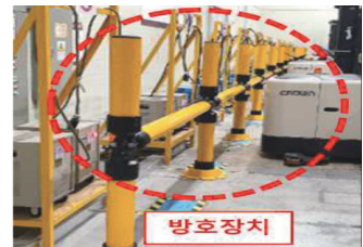
방호장치 설치 예시
